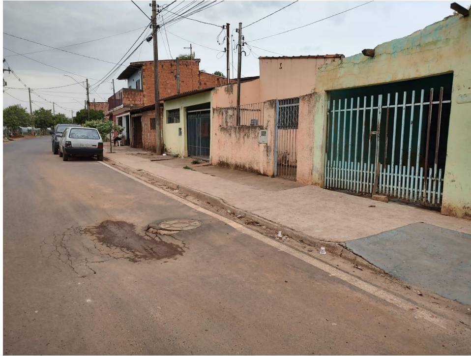
FOTO 2 - AFUNDAMENTO, FISSURAS E TRINCAS
