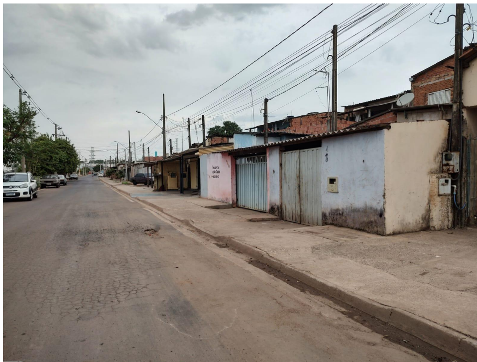
FOTO 1 - AFUNDAMENTO LONGITUDINAL, FISSURAS, TRINCAS E BURACO
