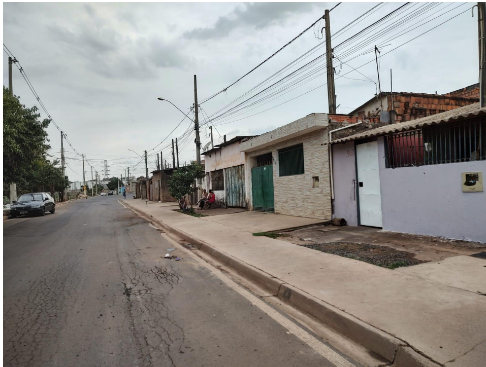
FOTO 4 - AFUNDAMENTO LONGITUDINAL, FISSURAS, TRINCAS E BURACO
