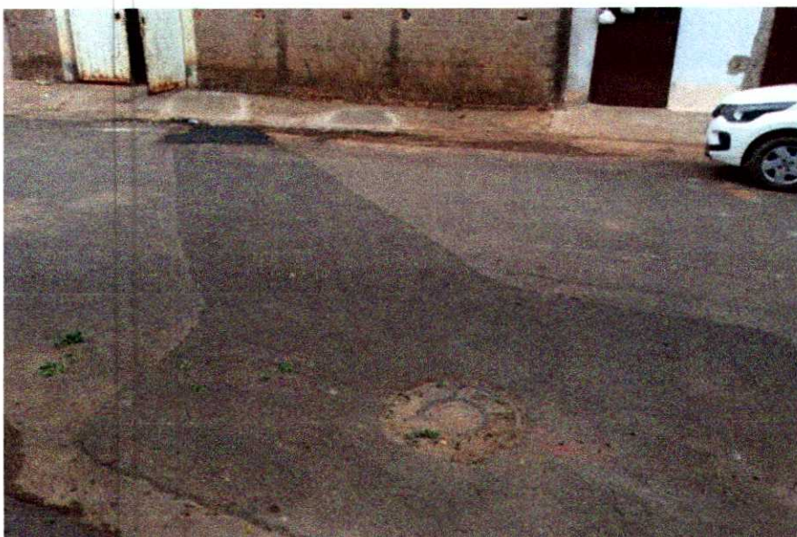
Imagem 3 - Reparo Asfáltico localizado a Rua Albina Moraes Peres, 93 - Jardim Anésia.
